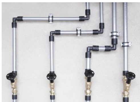
Rozdeľovanie studenej vody pomocou systému RAUTITAN
